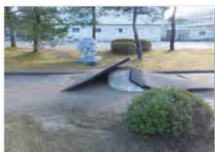
3 汚水配管損傷（正面道路）
