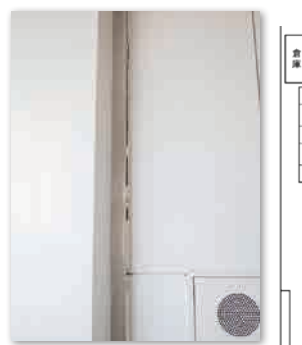
2 壁破損（教室棟通路）
