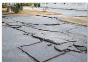
4 液状化痕（正面玄関前）
