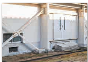
5 崩れた踏み台（第1体育館）
