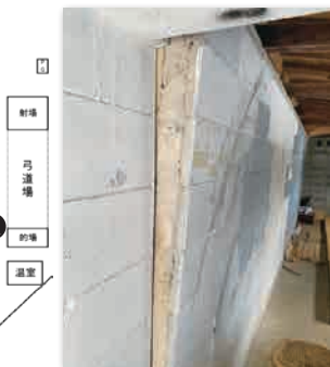
11 傾いた壁（弓道場）
